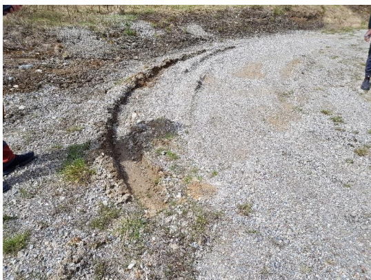
M7B Skada mark 2023 behov åtgärder 2024?
