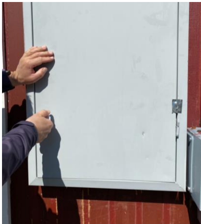
M4C Elskåpsfront är trasig. Åtgärdas av snickare
