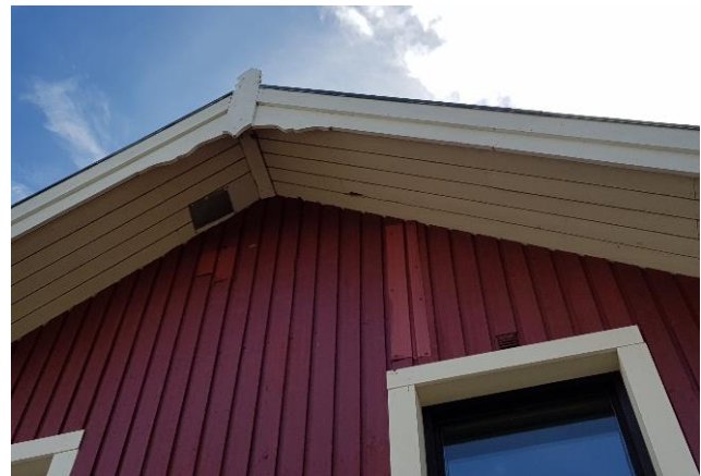
M7D Hackspett-skada undersida av takutsprång
