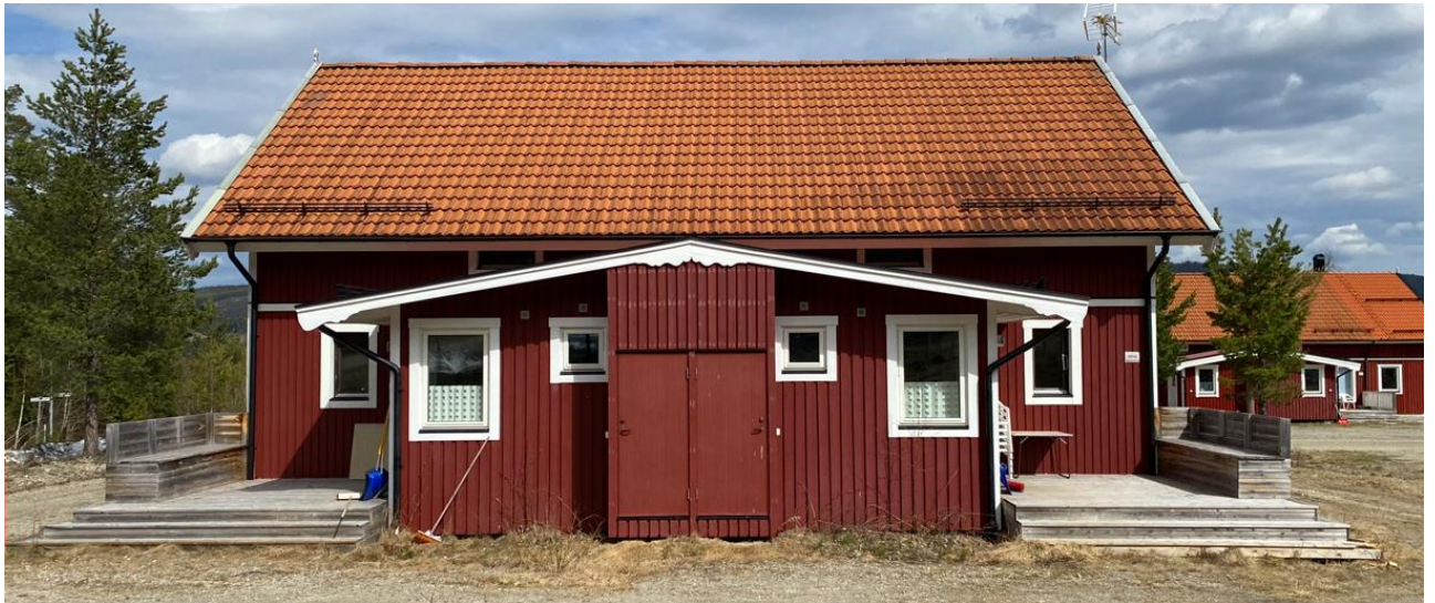
7B Skador på trappa efter snöröjning alt påkörd av bil. Tovor mot fasad. Åtgärdas av medlem.
